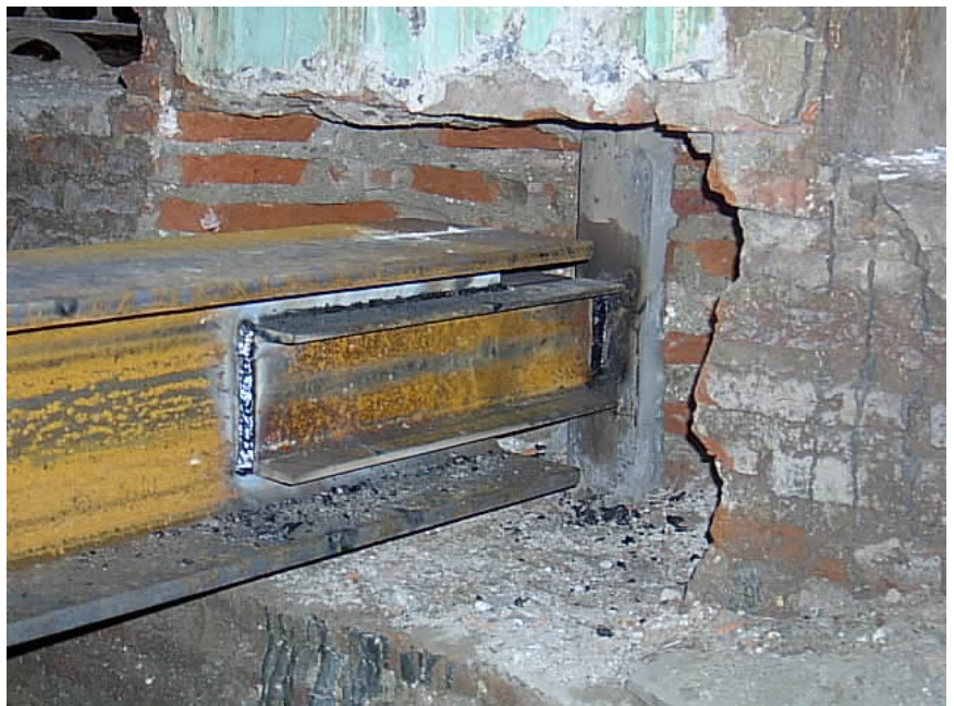
Figura 25. Ejecución de los micropilotes desde plataformas construidas al efecto. Enlace de los perfiles de estructura horizontal a los micropilotes.
