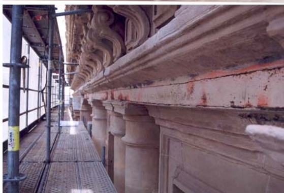
Figura 26. Fachada principal y detalle parcial de unos perfiles que, a modo de dinteles-cargadero, dispuso con la mejor intención el arquitecto autor del proyecto en 1899. Un siglo después, la corrosión de los perfiles convirtió a éstos en un cáncer que amenazaba con la integridad de la parte alta del edificio (ver también las figuras 9 y 10).
