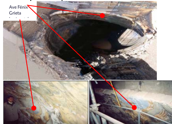
Figura 13. La experiencia y el estudio de la cúpula colapsada (figura inferior) permitió inferir la existencia, confirmada, de grietas según el paralelo en otra cúpula gemela de la misma iglesia (figura superior). Santo Tomás de Villanueva (Zaragoza). Trabajo de los autores [11].
