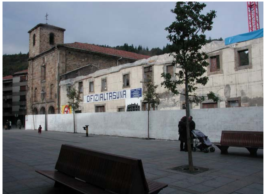
Figura 22. En la parte superior, planta del edificio y su claustro. En la figura inferior, vista del edificio durante las obras.
