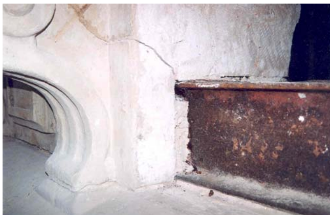
Figura 9. Efecto producido por la corrosión de unos viejos perfiles metálicos (dispuestos durante la construcción en 1899) en unos dinteles de un edificio oficial. Obsérvese la fisuración de los canes y el estado de corrosión de los perfiles, una vez retiradas las metopas. Trabajo de los autores (2000).
