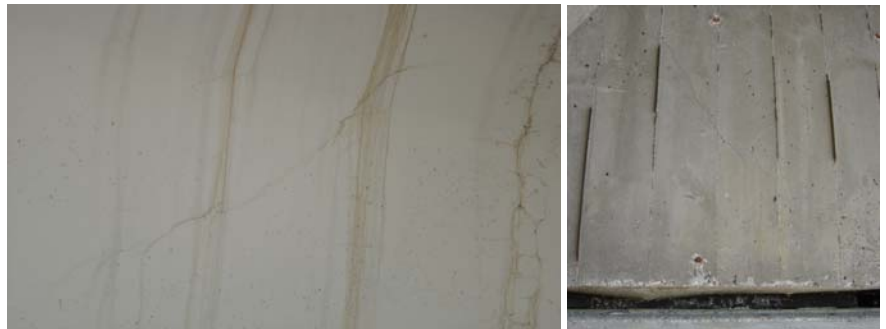
Figura 14. A la izquierda, fisura de cortante en almas de piezas artesas. De abertura moderada, estas fisuras se han encontrado con gran frecuencia en estructuras construidas en la última década. A la derecha, fisuración que pone de manifiesto la existencia de una biela comprimida en la riostra de apoyo de un puente losa, buscando el neopreno.
