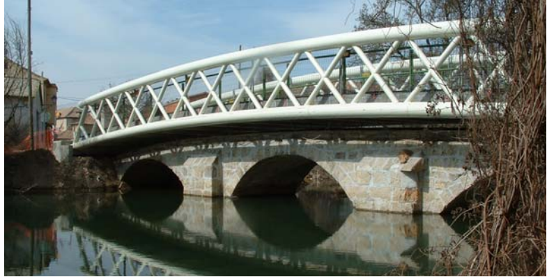
Figura 17. Ejemplo de intervención desafortunada en un puente histórico, fruto de la ignorancia de las posibilidades de un puente existente y de la insensibilidad.
