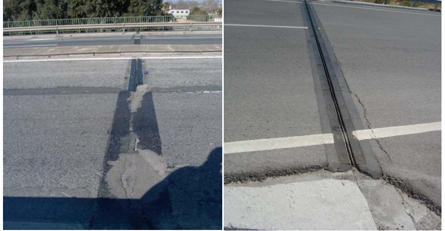
Figura 23. Daños en juntas, muchas veces inevitables, pero fuente de problemas.
