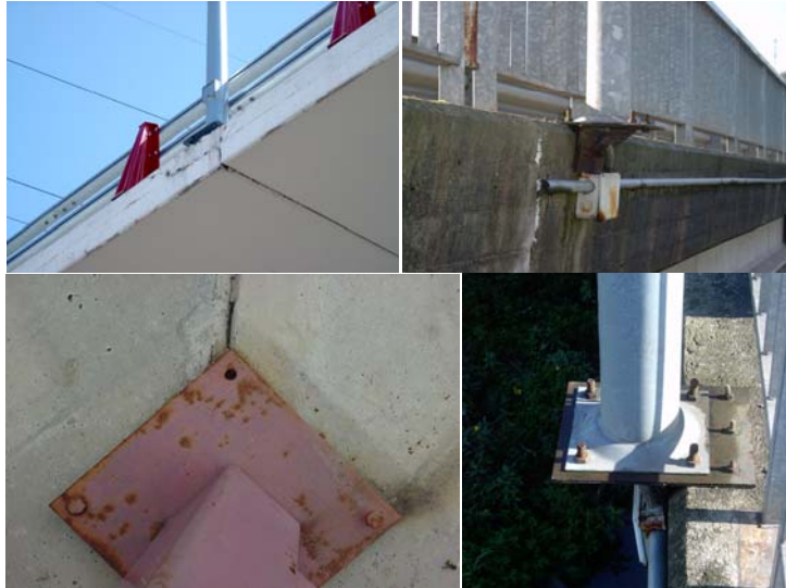
Figura 25. Situación de ciertas sujeciones de luminarias y de postes de señalización.
