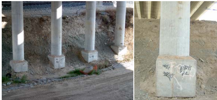
Figura 7. Vista, en principio alarmante, del encepado de los fustes de un paso sobre el ferrocarril.
