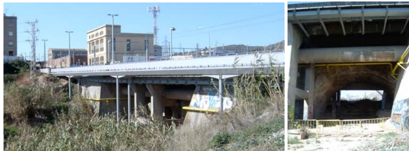
Figura 4. Puente complejo de inventariar y de inspeccionar.
