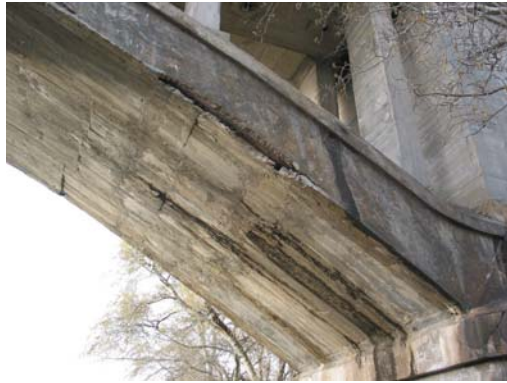
Figura 20. Vista de un puente arco de hormigón con daños debidos a corrosión de los cuchillos de autocimbra.
