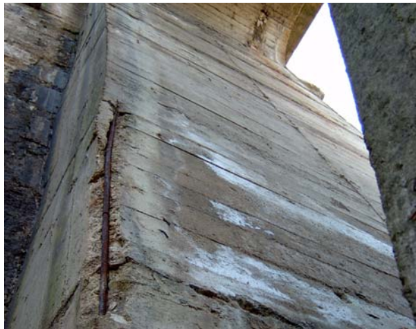
Figura 12. Armadura a la vista, ligeramente oxidada, expuesta al ambiente desde el momento del desencofrado.
