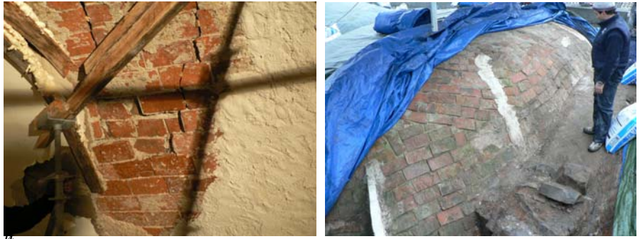
Figura 4 y 5. Vista del trasdós de una de las bóvedas durante la reparación. Vista del intradós de una de las bóvedas durante la reparación. Se observa la presencia de dos fisuras según los meridianos.
