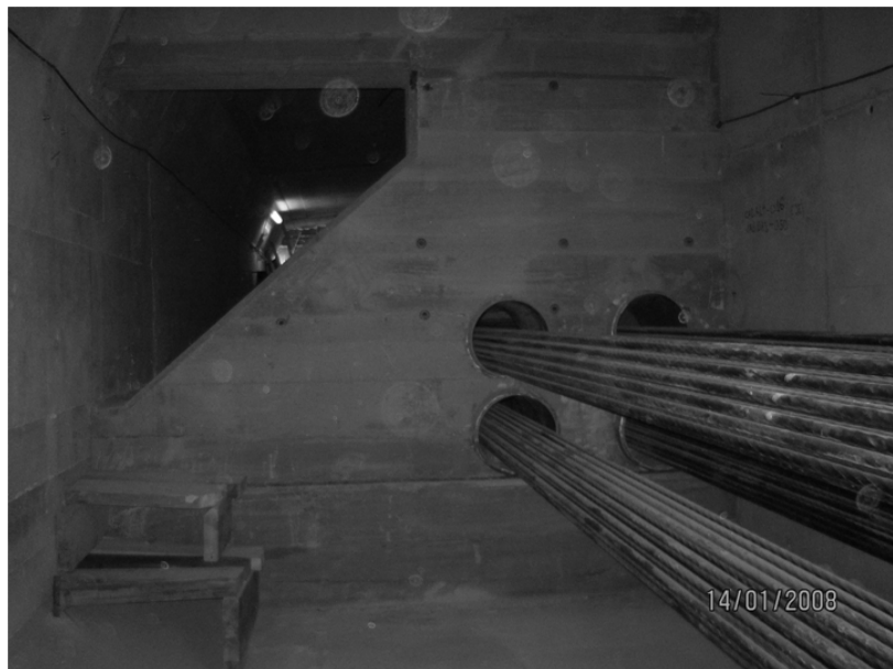
Fig. 12. Vista del pretensado exterior atravesando un diafragma pensado para limitar la distorsión del tablero.
