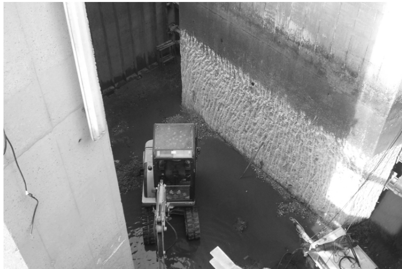
Fig. 3. Vista del espacio entre dos pantallas. Se aprecian las superficies de hormigón tratadas para aumentar la rugosidad.
